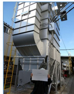
株式会社中東様 集塵設備
