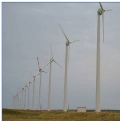
北海道幌延町にある「オトンレイ風力発電所」 (合計28基 総出力21,000kW)
