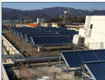
出典：株式会社寺田鉄工所様 太陽熱設備導入事例
